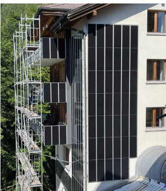
Photovoltaikanlage am Waldhaus
